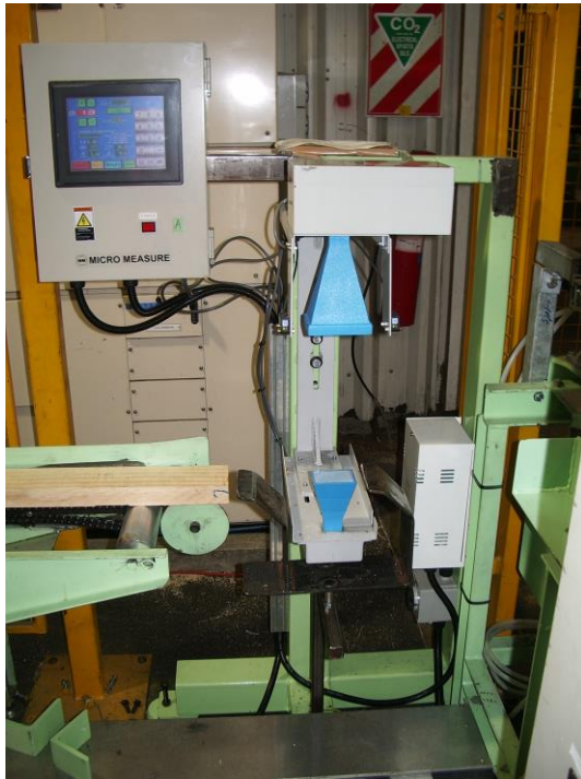
木材工場設置例
